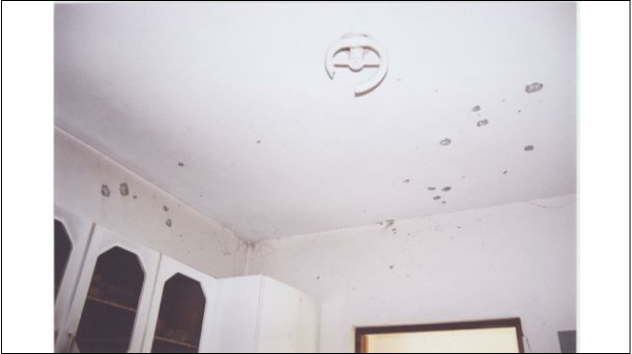
Foto 17 – Marcas de disparos en el área de la cocina
