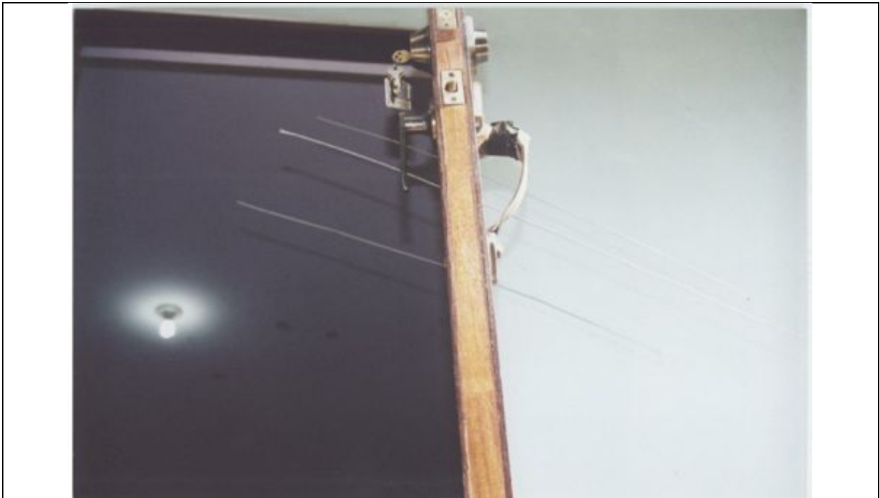
Foto 20 – Impactos en el techo de los disparos que atravesaron la puerta principal
